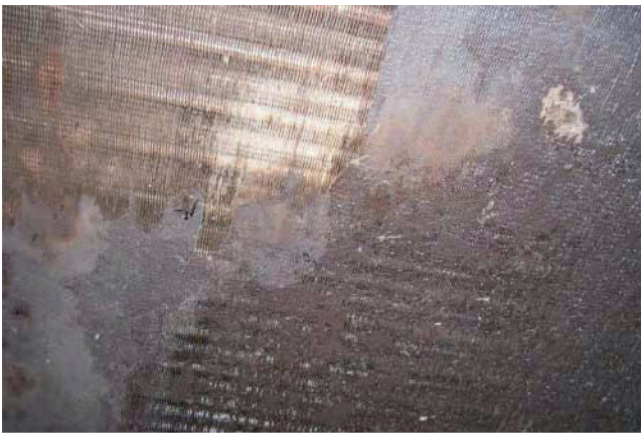
Abb. 1: Verschmutzter Verflüssiger, die Lamellen verschließen sich langsam.
